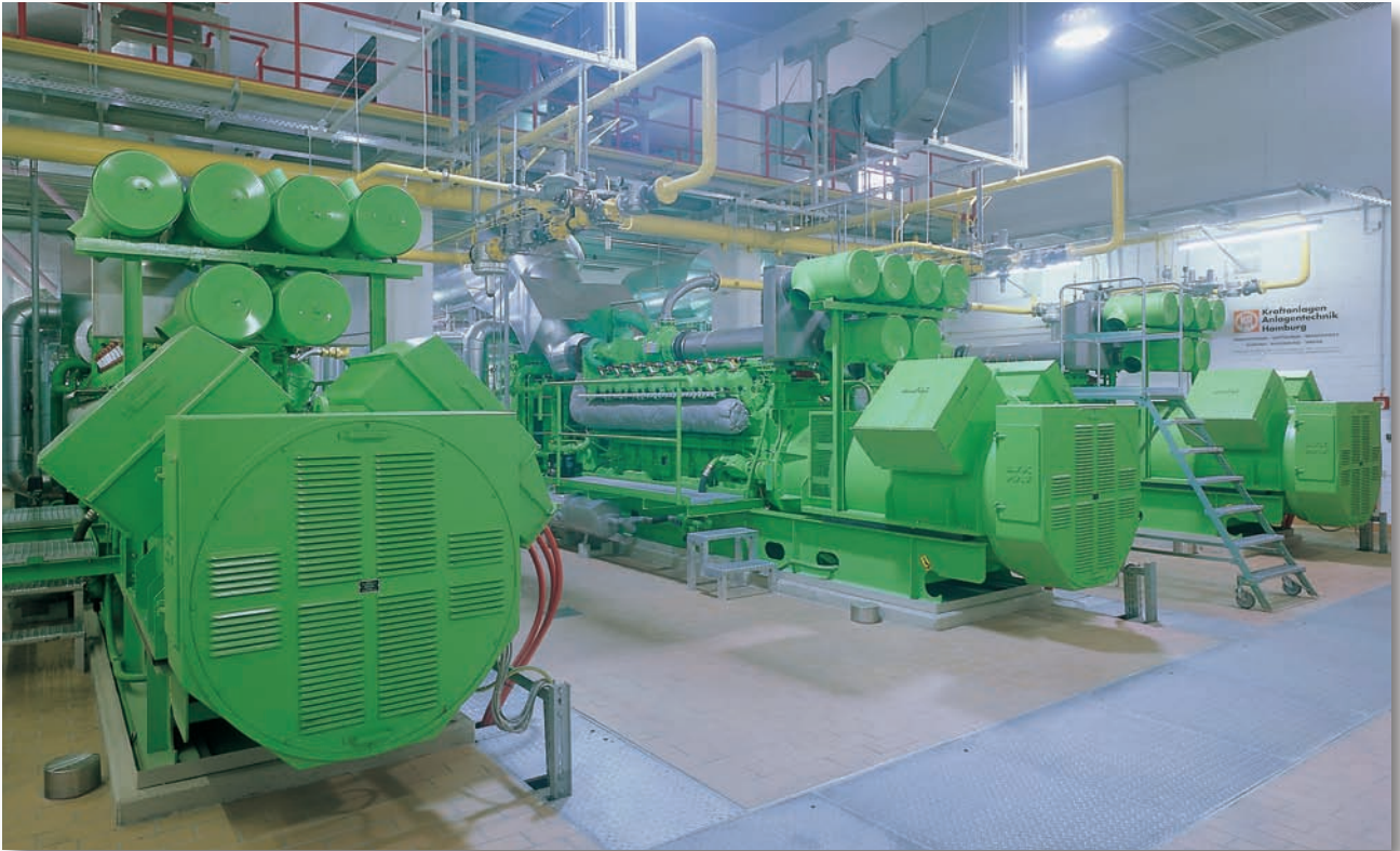
Blockheizkraftwerk Am Kupferhammer, Wernigerode
