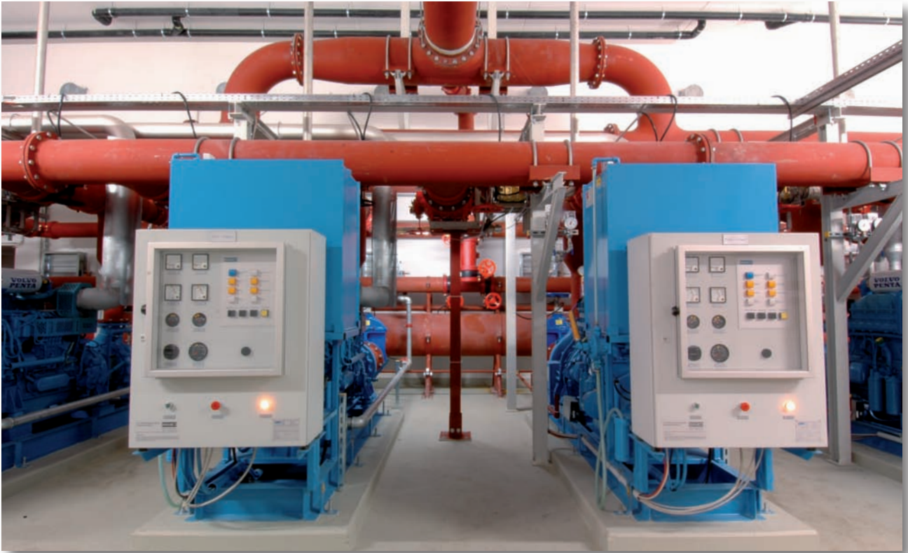
Sprühwasserlösch- und Sprinkleranlage FIEGE Mega-Center, Hamburg
