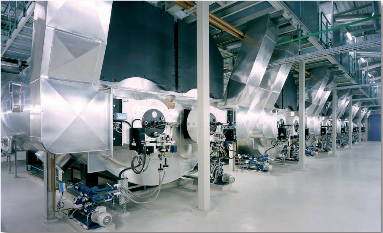
Besicherungs- und Spitzenlast- Heißwasseranlage, Westerholt
