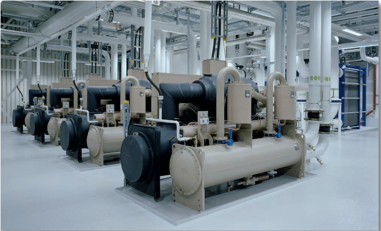
Kälteanlage Volkswagen-Werk, Emden
